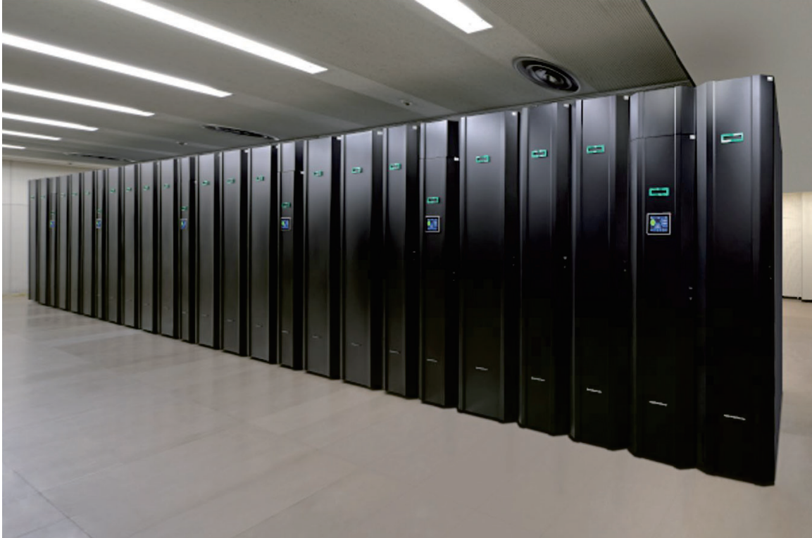
図 ラックの外観
