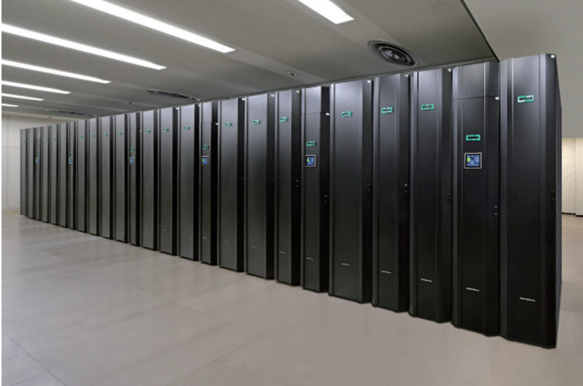
図 ラックの外観
